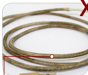
Sinais claros de desgaste devido a má conservação
